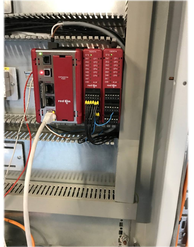
Deprem ve Alarm Verileri Endüstriyel Kayıt Sistemi
